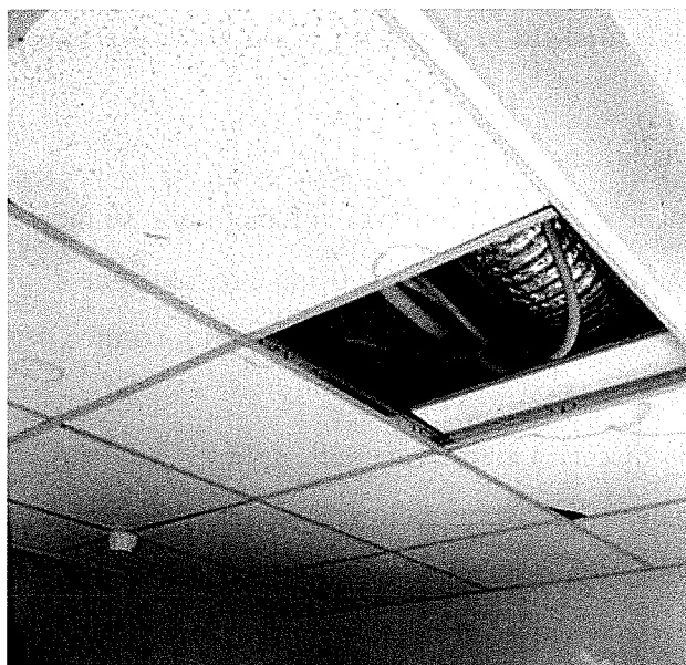
Fig. 2 – Unità interna a servizio del Laboratorio di istopatologia di Anatomia (posizione: in controsoffitto corridoio uscita emergenza)
