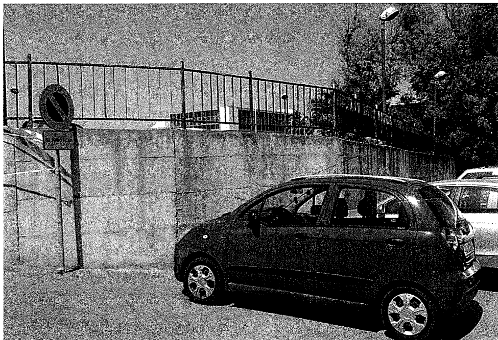
Figura 4 (FT2) Parapetto su terrapieno, parcheggi zona ingresso posteriore
